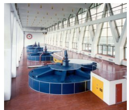
© Kraftwerk Birsfelden AG
